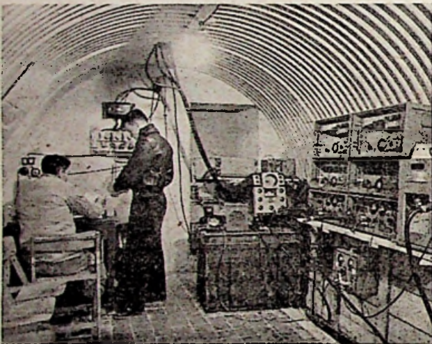
Het relaystation bij Calals, om precies te zijn bij Blanc Nez, is ondergebracht in een voormalige Duitse bunker.
